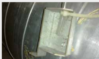
État de l'installation après 2 ans de fonctionnement
