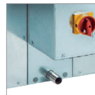
Sortie latérale du conduit d'évacuation des condensats
