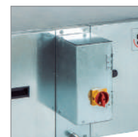
Armoire électrique intégrée Interrupteur marche-arrêt de sécurité.
